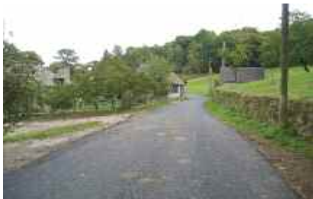
La VC 2 Le Mons sur la partie la plus dégradée
